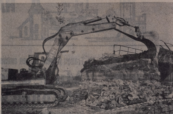
Mit schwerem Gerät rückte gestern nachmittag eine Baufirma der ehemaligen Eisenbahnbrücke in Schwenke zu Leibe. Bund und Märkischer Kreis sind derzeit dabei, hier die K 4075 rechtwinklig an die Bundesstraße 229 anzubinden.
